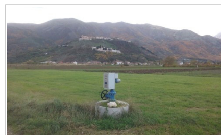
Gruppo di consegna irriguo nuovo comizio "Marchesina-Barchitello" - Potenziamento impianto di automazione e telecontrollo. Lavori di Irrigazione, PSR Campania 2007-2013 Misura 125.1.
