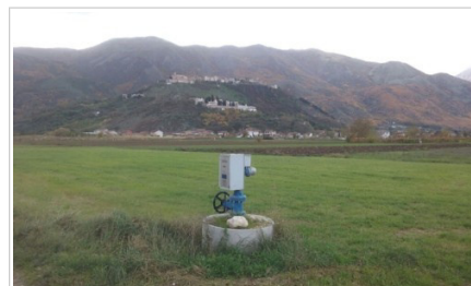
Gruppo di consegna irriguo nuovo comizio "Marchesina-Barchittello" - Potenziamento impianto di automazione e telecontrollo. Lavori di Irrigazione, PSR Campania 2007-2013 Misura 125.1.
